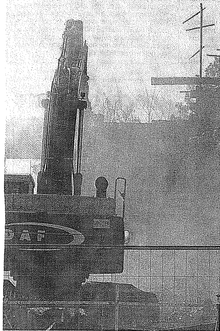
La prima fase degli abbattimenti degli immobili delocalizzati si è conclusa tra maggio e giugno scorso secondo cronoprogramma (Blitz)
